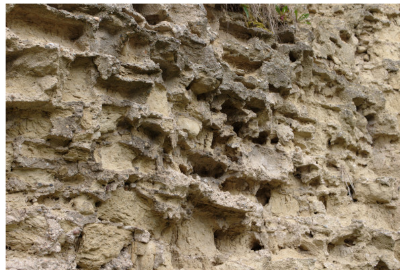
Detail rozpadajícího se zdiva – Dražice
